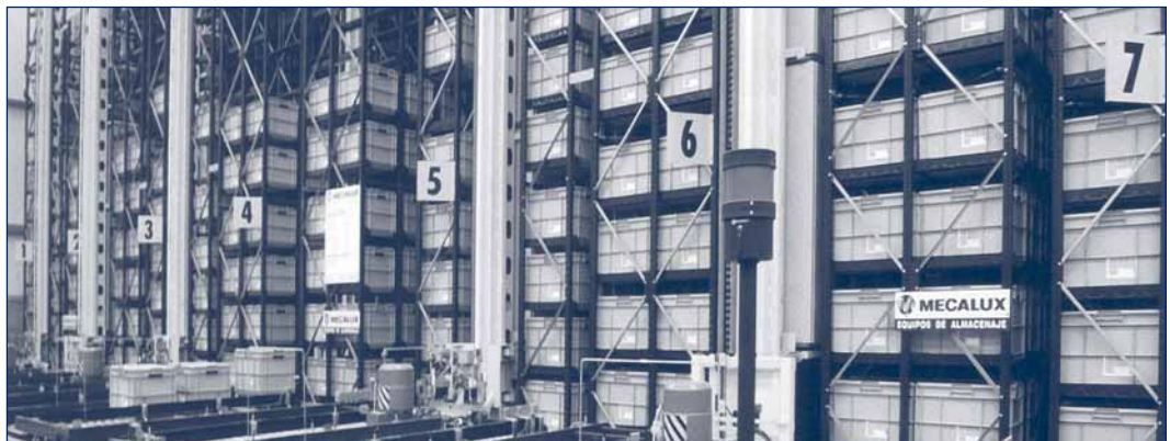
Fig. 1.8. Almacén mecanizado. (Cortesía de Mecalux).
