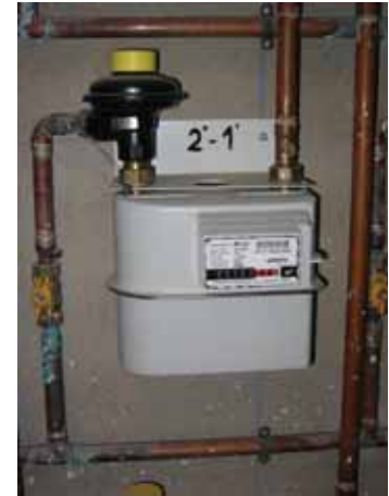
Comptador de gas.
