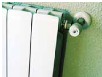
Radiador d'alumini d'una instal·lació de calefacció.
