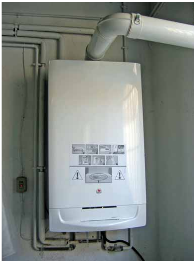
Caldera mixta de calefacció i d'ACS.
