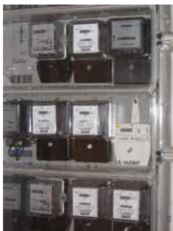
Centralització de comptadors.
