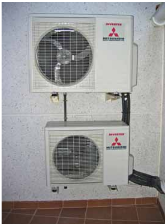
Condensadors d'un sistema de climatització.
