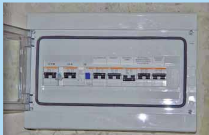
Quadre de comandament.
