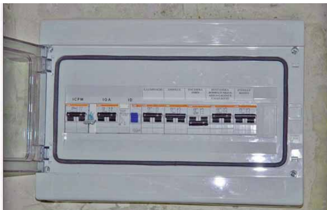
Quadre de comandament i protecció.
